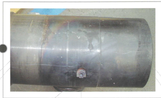
Esempio di surriscaldamento Overheating example
